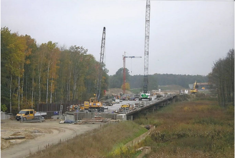
Bau einer neuen Landstraße L 40 nach Autobahn-Standard, hier: Bau einer doppelten Brücke zur Überquerung des tiefen Moores „Hartes Fenn“ in Güterfelde. Quelle: Archiv Peter Ernst.
